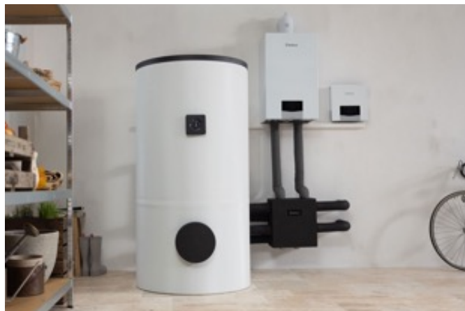
Hibridni sistem s plinskim ecoTEC kotlom, upravljalno enoto za toplotno črpalko in vsebnikom za toplo vodo
