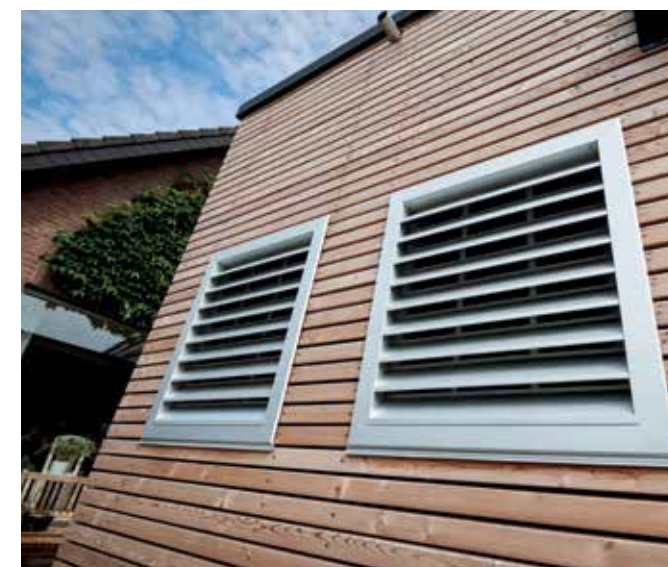
Edino kar je vidno zunaj so rešetke za dovod in odvod zraka
